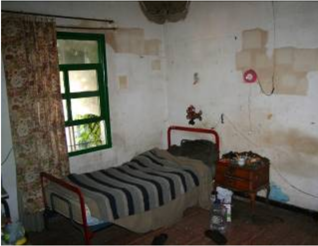
Humidades en interior de cuarto
