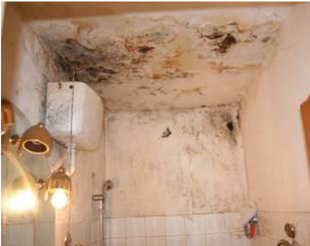
Humidades en teito de cuarto de baño
