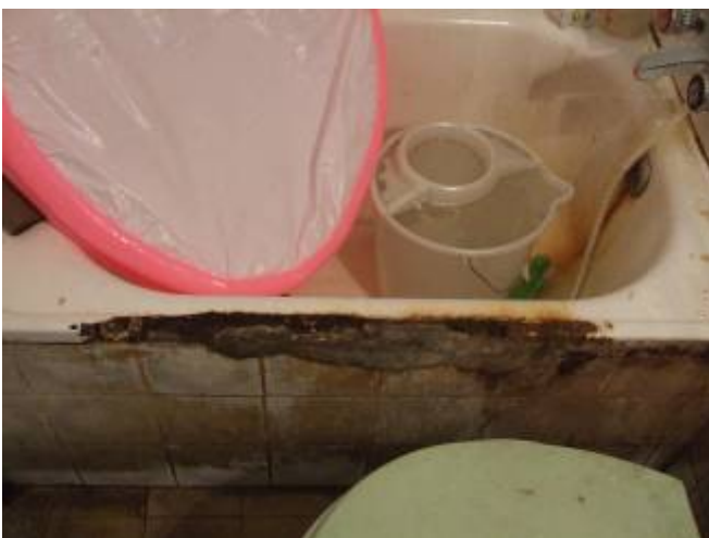
Bañeira con corrosión
