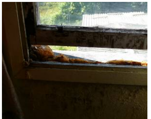
Entrada de auga polas carpinterías
