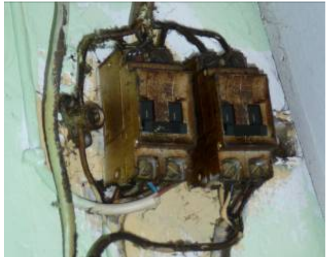
Interruptores xerais de electricidade dunha vivenda
