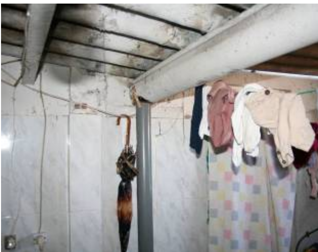
Recollida pluviais en interior de baño
