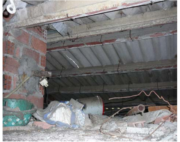
Cuberta do bloque B, sen illamento e con placas rotas
