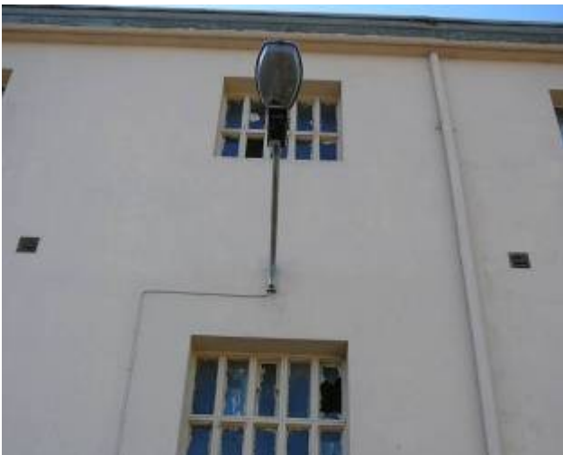
Ventás rotas en zonas comúns do bloque B
