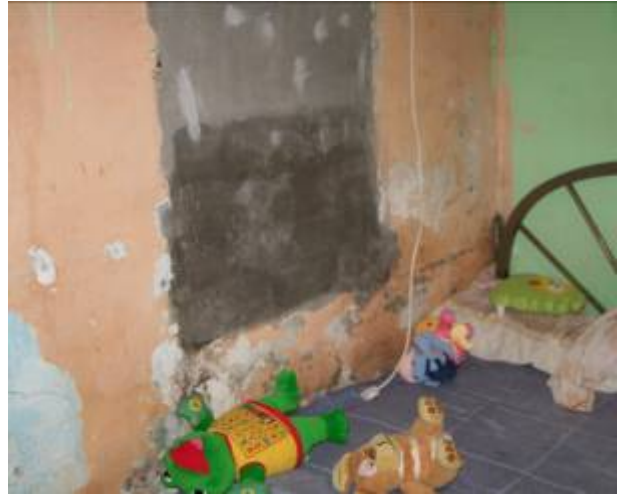
Tabique en dormitorio
