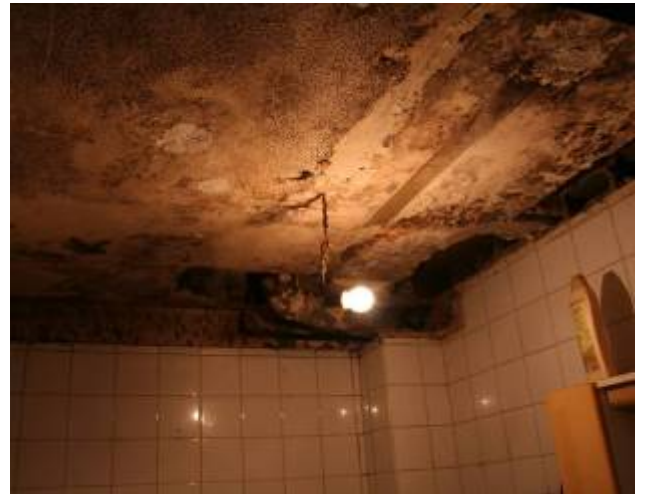
Condensacións e humidades en teito de cuarto de baño
