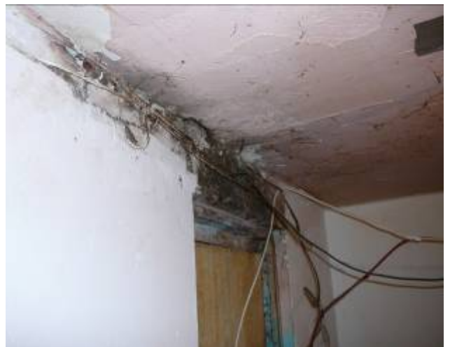
Cableado deficiente dunha instalación eléctrica
