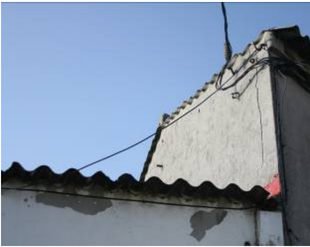
Fisura en fachada
